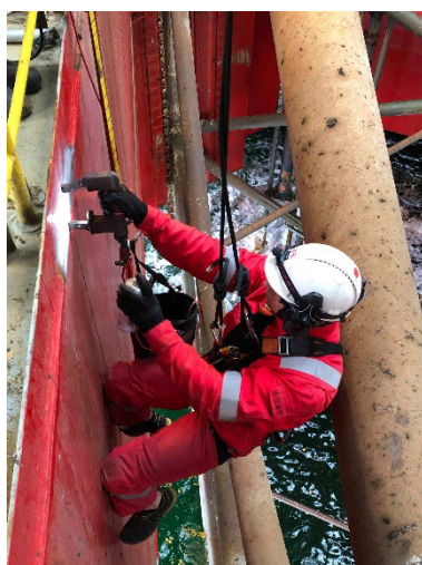
Nikolai Uzunov hos Aker Solutions i Egersund utfører MT på skroget på Yme som lå til kai der
