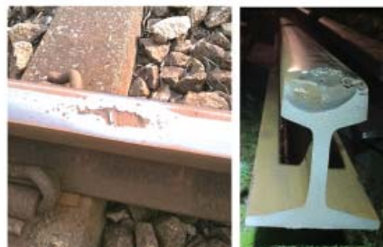
Her ser vi et bilde av skinneskade og skinnebrudd.
