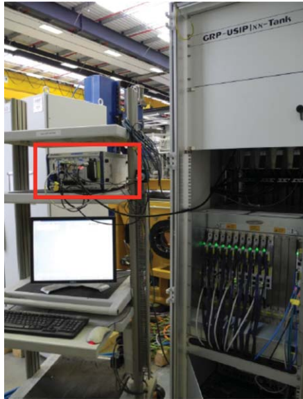
Fig. 1: Automatisert test system (rød boks) for on-site instrument verifisering
