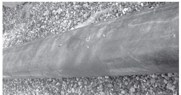
Fig. 2. Seks tomme stålrør ledning med afmonteret ydre isolering. Lokalt er røret med nominal tykkelse 10 mm tæt udvendigt således at kun en resttykkelse på 4-5 mm er tilbage. En sådan voldsom udvendig korrosion ses bl.a. ved siden af markeringen "P".
