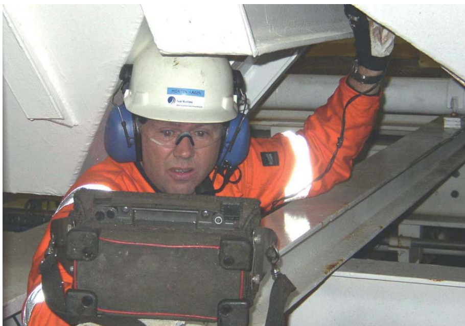
Artikkelforfatter utfører tykkelsesmåling med ultralyd av tilbakeslagstank på Gullfaks A
