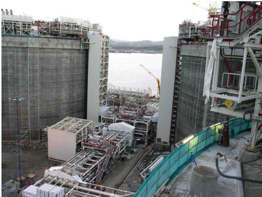
Det er betydelige mengder med rørgater på Melkøya. Mye av dette sjekkes av Noweco.
