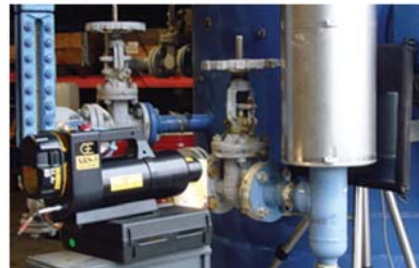
Korrosjon under isolasjon
