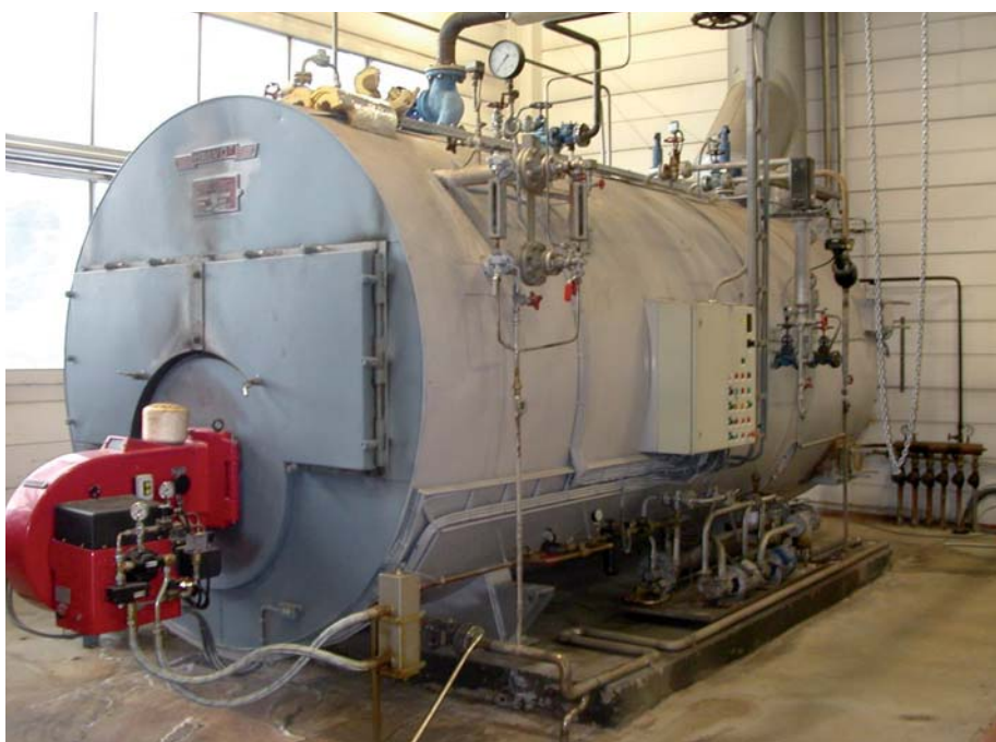
Fyrgang røykrørskjel i prosessanlegg
