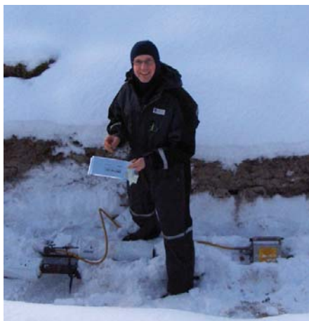
Fra RT-inspeksjon i Nord Norsk klima. Bildet viser Roger Wilhelmsen i ferd med å bytte film ifm. kontroll av fjernvarmelinje på Andøya Flystasjon.
