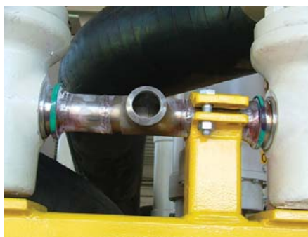
NDT utfordring, manifold piping mellom 2 ventiler hvor support er i veien, support måtte flyttes
