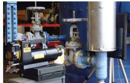
Korrosjon under isolasjon
