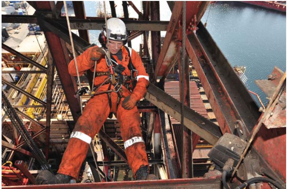
Inspektør og sikringsleder Allan Wullf jobber med inspeksjon av boretårn. Foto Ken Alvin Jenssen.
