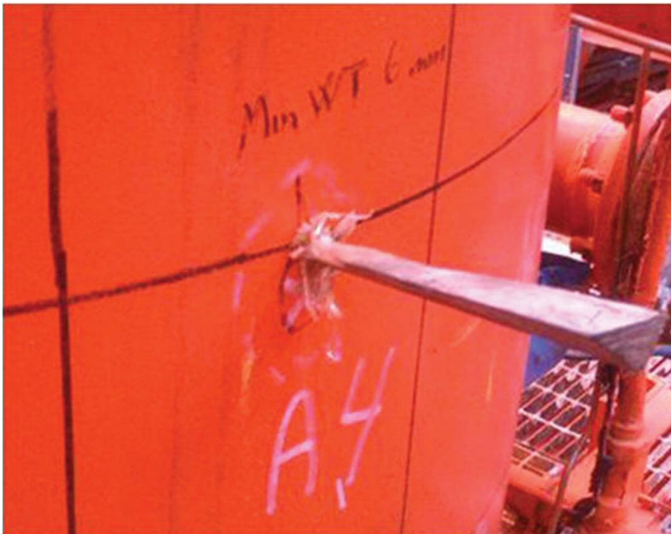
På bildet ser vi samme området som på P-Scan fotografert 2 mnd senere, med trekile banket inn i området hvor det ble lekkasje.
